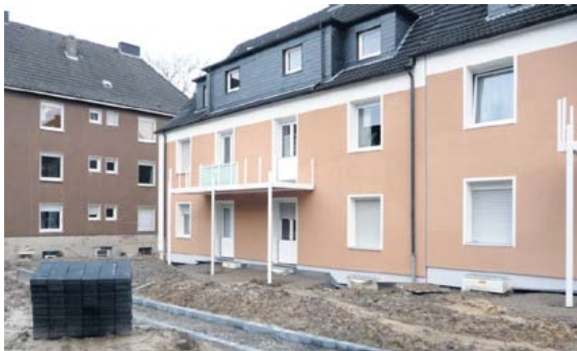
In dem Teil des Karrees, in dem am Rosenmontag gerodet wurde, sind die Modernisierungsarbeiten voll im Gang.
